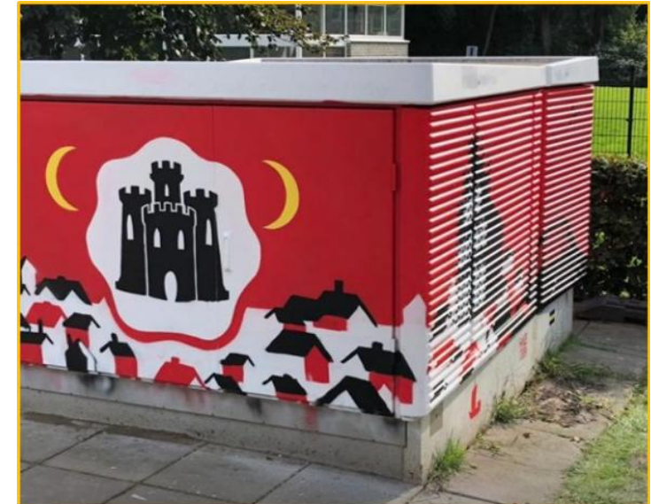
Een transformatorhuisje in de buurt
