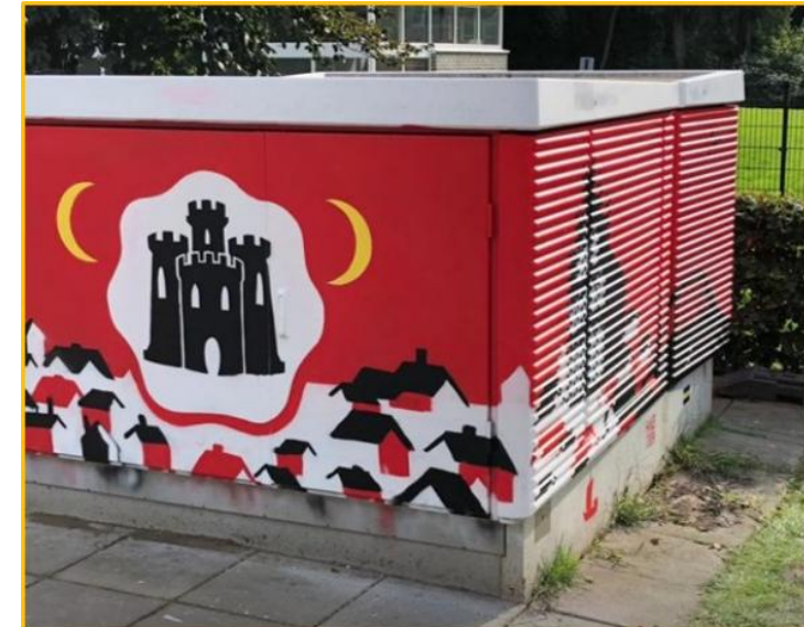
Een transformatorhuisje in de buurt
